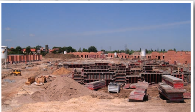
Izolace 10.000 m 2 Základové desky na výstavbě RD v Novém Jenštejně u Prahy, 10000 m 2 GD: Ferobuilding a.s., 2005
