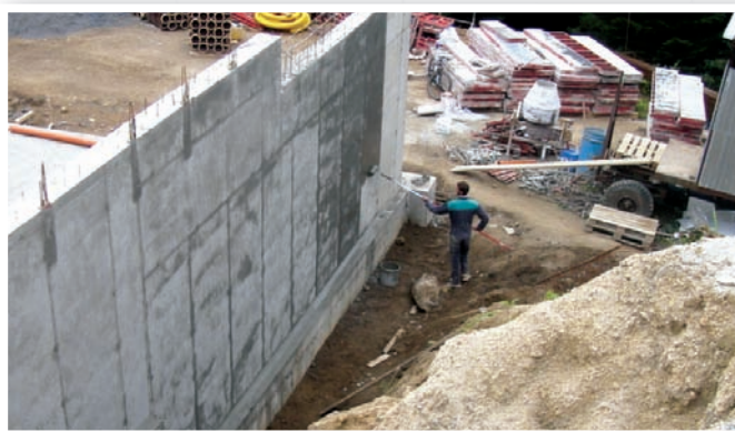
Izolace spodní stavby RD Firmy Soare s.r.o. v Jablonci nad Nisou, 2100 m 2 Dodavatel: Havax a.s. Liberec, 2002
