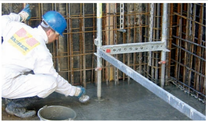
Izolace základové desky Polyfunkční dům v Lipové v Liberci, 600 m 2 GD: Metrostav a.s., 2005
