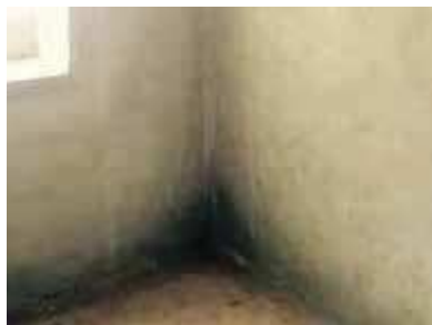
Obr. 6 - Nemocnice - vysychající stěrka, plesnivý roh
