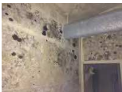
Obr. 1 - Škody způsobené plísněmi ve starých, opuštěných objektech
