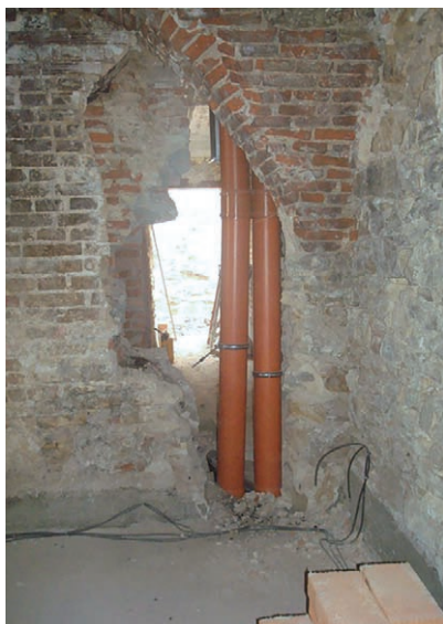
Znehodnocení díla poškozením injektáže
