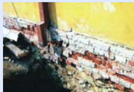
U starších objektů, kde mnohdy chybí drenáže a zpevněné základy, nedochází k přirozenému odtoku vody z podzákladů
