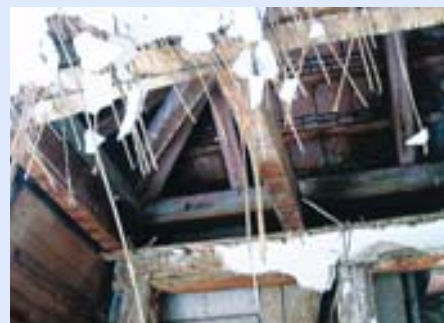
Nepřiměřené stavební úpravy podkroví bývají často příčinou statických poruch
